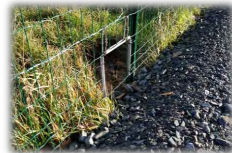
Exemple de passage à faune – CERMECO
